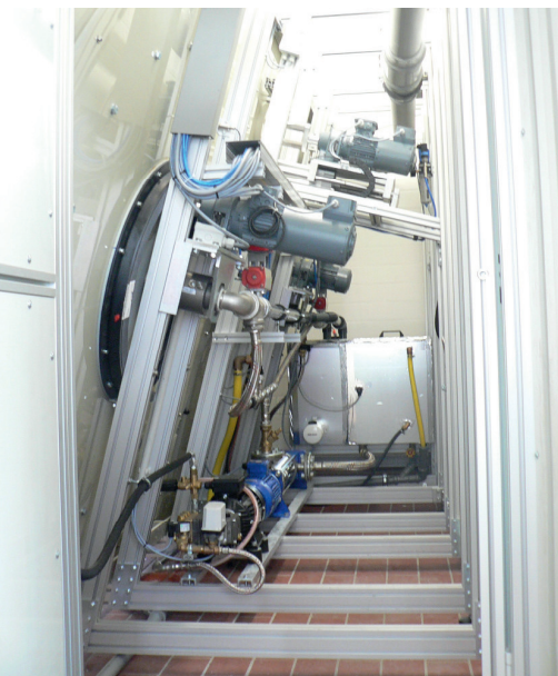
Voorbeeld: technische onderhoudsvriendelijke ruimte achter in de installatie SPZ-K Classic Line en Basic Line
