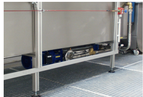
(roestvrijstalen testpomp zonder vloer onder het pompput)
